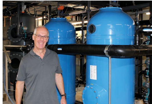
Filter mit Aktivkohle, die für die Neutralisation zuständig sind.
