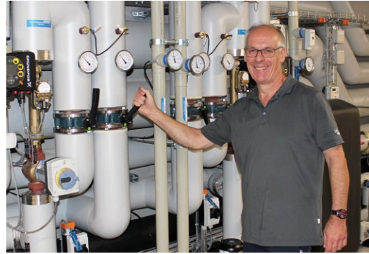
Heizungsverteilung der Becken für die Wassertemperatur.
