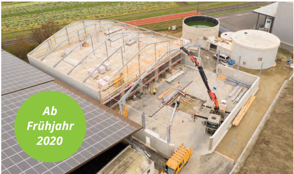
Biogasanlage in Tägerwilen.
